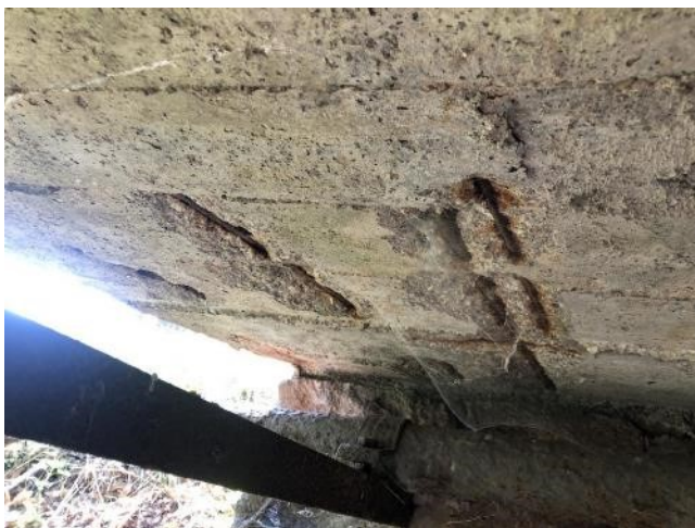
IMG_8362 - Na podhledu NK VPRAVO se vyskytují stopy po zatékání, obnažené třmínky i nosná výztuž, na
