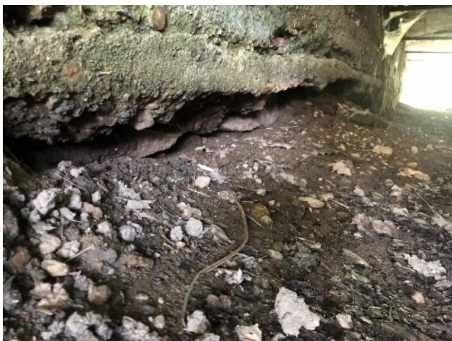
IMG_8337 - opěra O2 je lokálně podemletá do hloubky cca 40cm
