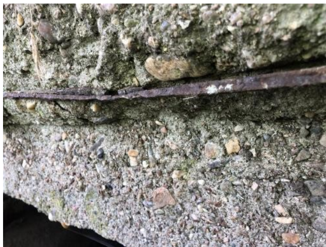
IMG_8348 - Hlubková degradace povrchu levé římsy, obnažená výztuž, koroze
