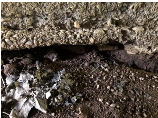
IMG_8340 - opěra O2 je lokálně podemletá do hloubky cca 40cm
