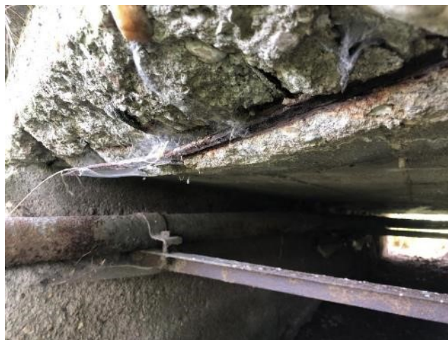
IMG_8353 - Na podhledu NK VLEVO se vyskytují stopy po zatékání, obnažené třmínky i nosná výztuž, nap
