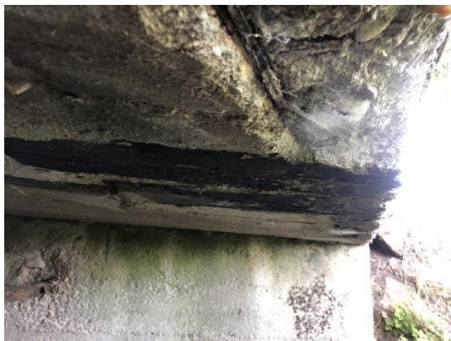
IMG_8352 - Na podhledu NK VLEVO se vyskytují stopy po zatékání, obnažené třmínky i nosná výztuž, nap
