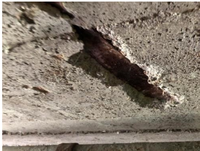
IMG_8361 - místy jsou na podhledu obnažené nosníky
