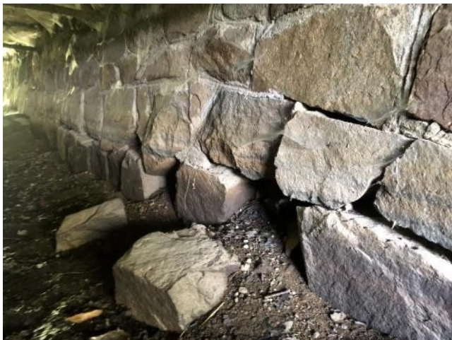
IMG_8322 - zdivo opěry O1 je lokálně podemleté, lokální kaverny, rozvolněné zdivo !!
