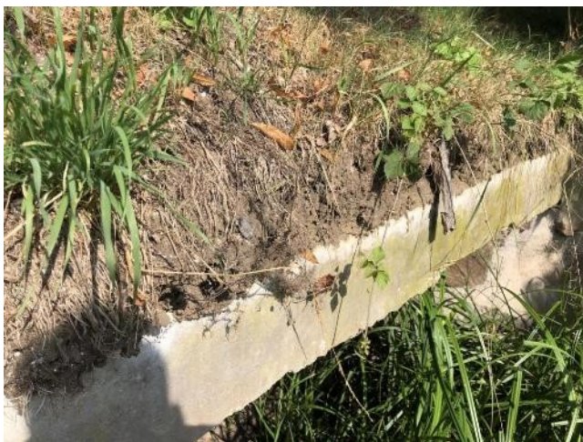
IMG_8365 - římsy jsou značně přesypané zeminou a zarostlé trávou
