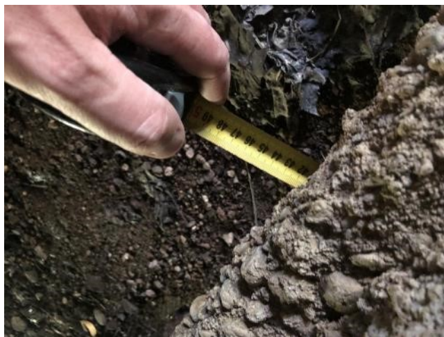
IMG_8338 - opěra O2 je lokálně podemletá do hloubky cca 40cm
