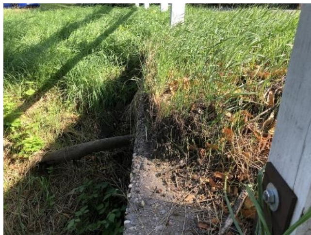
IMG_8309 - římsy jsou značně přesypané zeminou a zarostlé trávou
