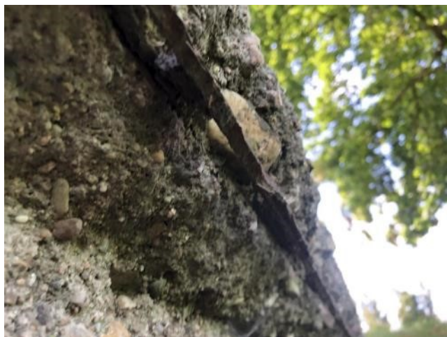
IMG_8347 - Hlubková degradace povrchu levé římsy, obnažená výztuž, koroze
