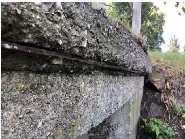
IMG_8346 - Hlubková degradace povrchu levé římsy, obnažená výztuž, koroze
