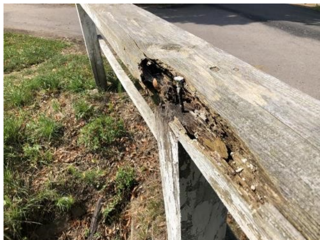
IMG_8317 - zábradlí vpravo je napadené hnilobou
