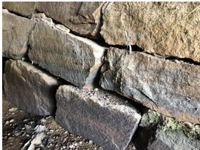
IMG_8324 - zdivo opěry O1 je lokálně podemleté, lokální kaverny, rozvolněné zdivo !!
