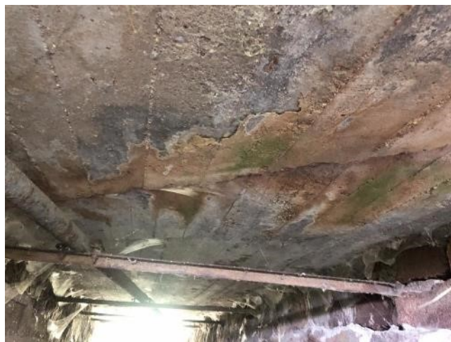
IMG_8355 - Na podhledu NK VLEVO se vyskytují stopy po zatékání, obnažené třmínky i nosná výztuž, nap
