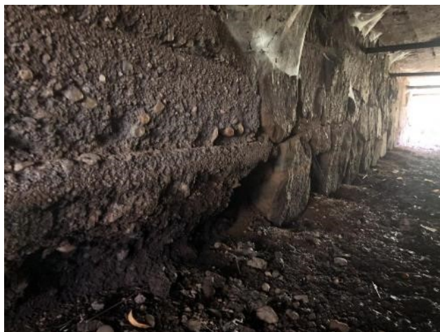
IMG_8341 - opěra O2 je lokálně podemletá do hloubky cca 40cm
