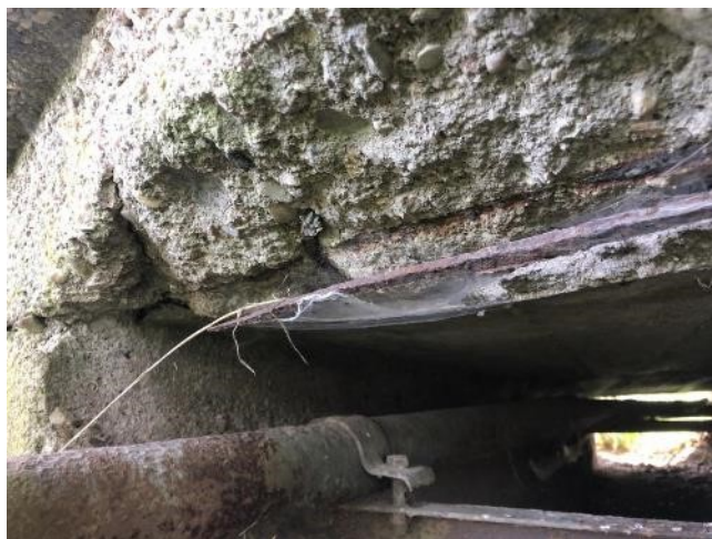
IMG_8354 - Na podhledu NK VLEVO se vyskytují stopy po zatékání, obnažené třmínky i nosná výztuž, nap
