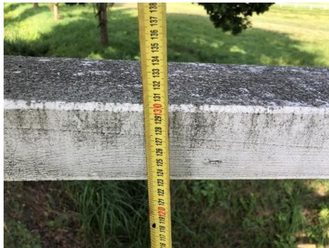
_dřevěné zábradlí vlevo má výšku 1300mm
