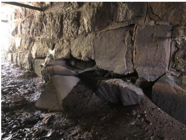
IMG_8325 - zdivo opěry O1 je lokálně podemleté, lokální kaverny, rozvolněné zdivo !!
