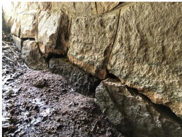
IMG_8327 - zdivo opěry O1 je lokálně podemleté, lokální kaverny, rozvolněné zdivo !!
