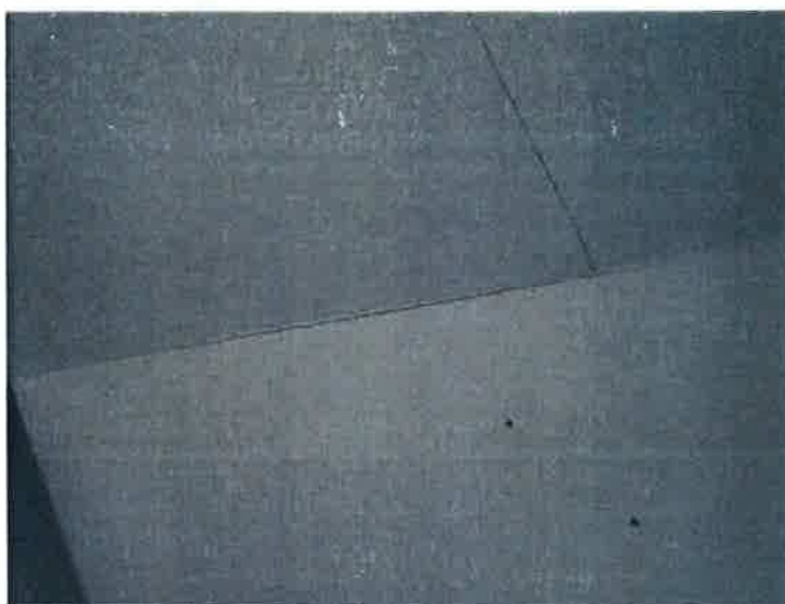
foto trhliny strop 929
