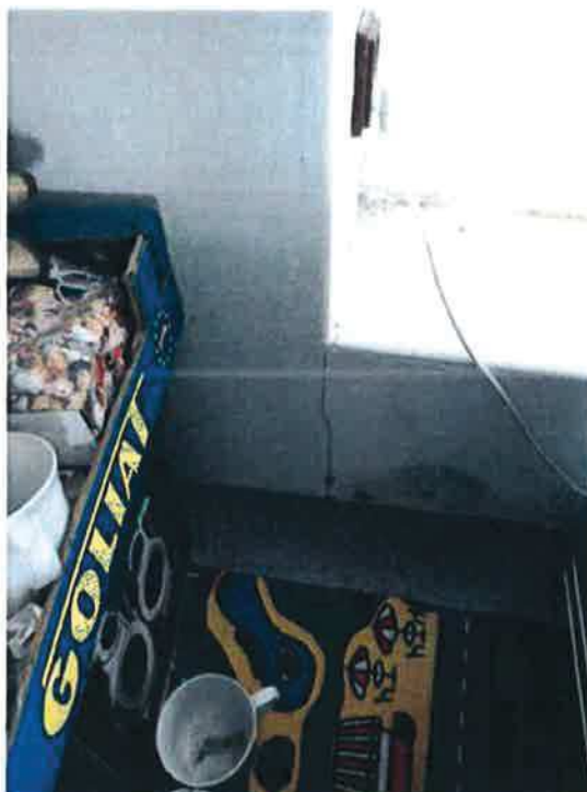
foto trhlina stěna 927
