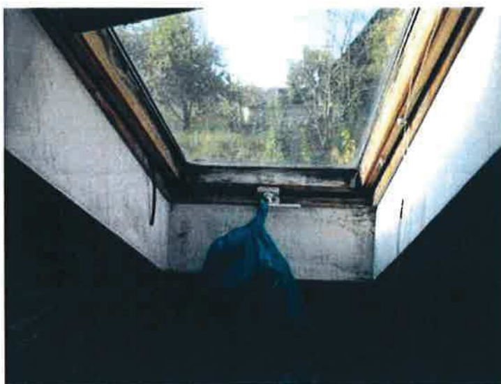
foto zatečení oknem 930
