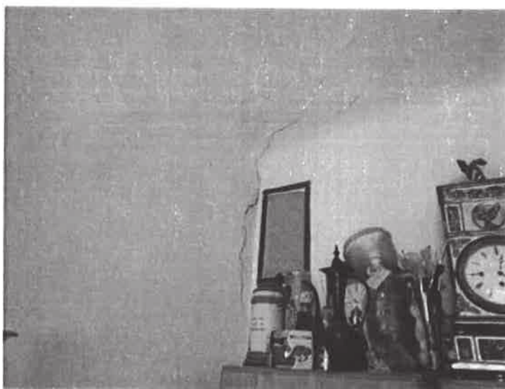
foto trhliny stěny 917
