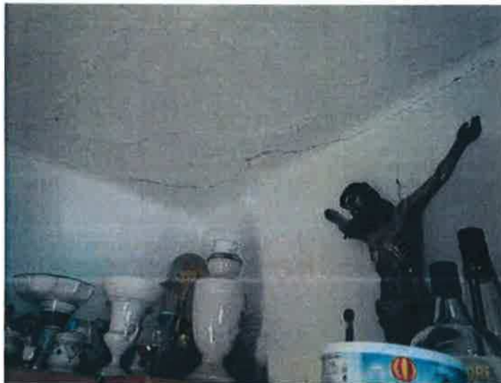
foto trhliny strop 914
