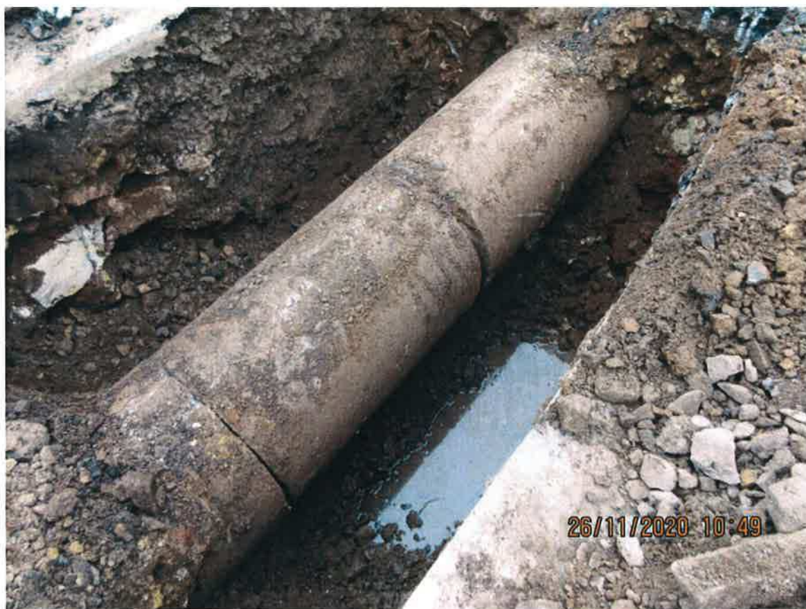
Nevyhovující stav propustku v km 1,109
